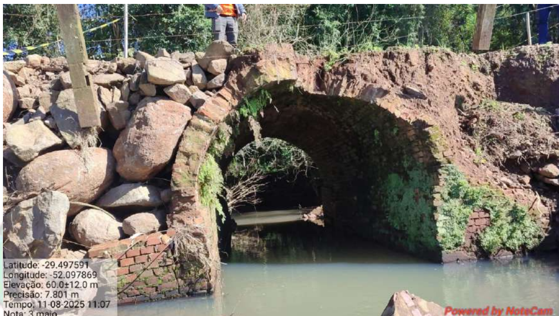
Imagem 2 – Desnível da alvenaria com risco estrutural
