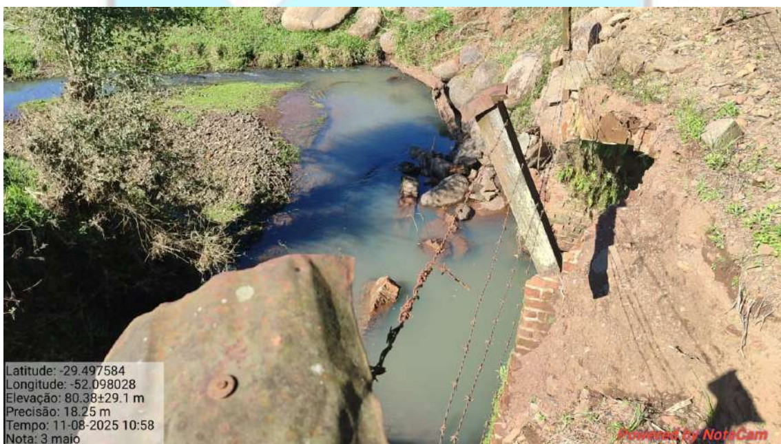
Imagem 5 – Queda de bordo e erosão de pista
