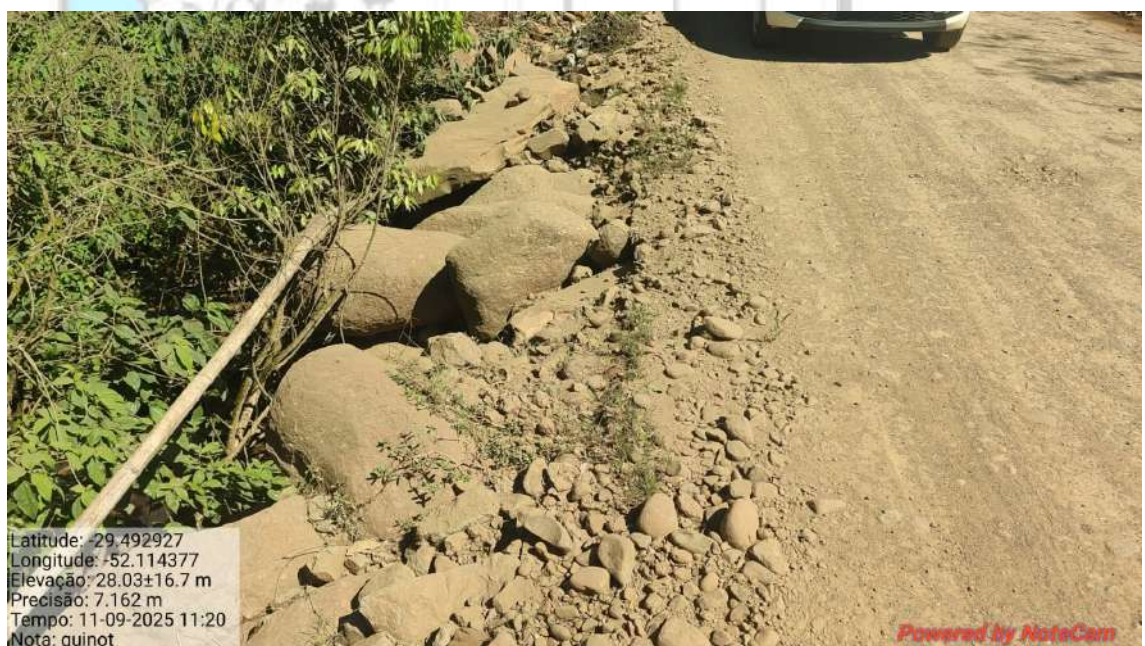
Imagem 2 – Estreitamento de pista evidenciado
