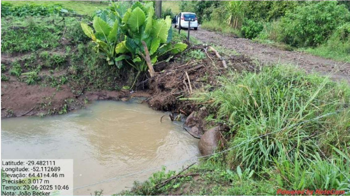
Imagem 4 – Estreitamento de pista e carreamento de solo
