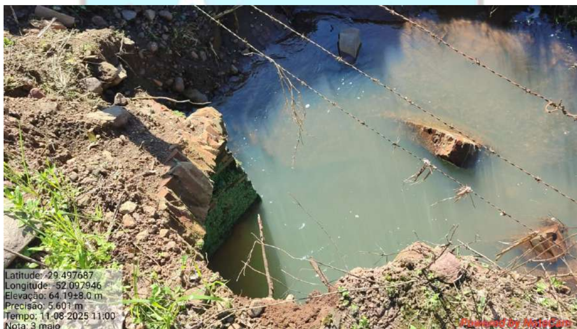
Imagem 3 – Queda de bordo e erosão de pista
