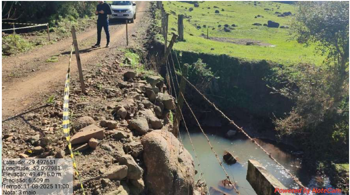
Imagem 6– Queda de bordo e estreitamento de pista
