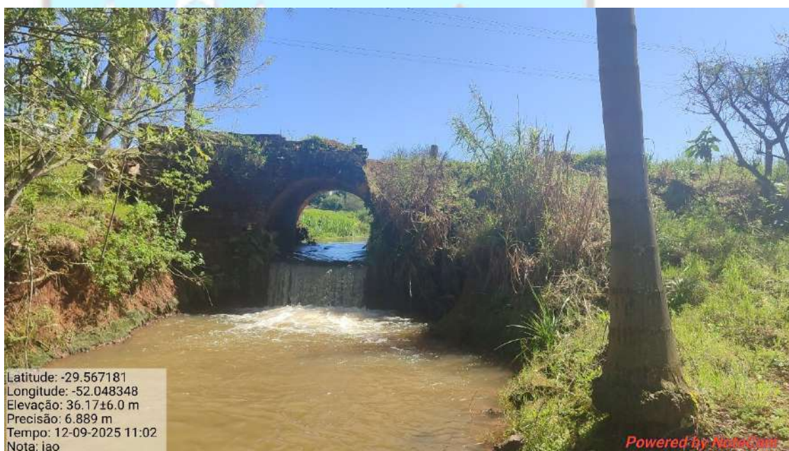
Imagem 6 – Queda de borda + Erosão Solo
