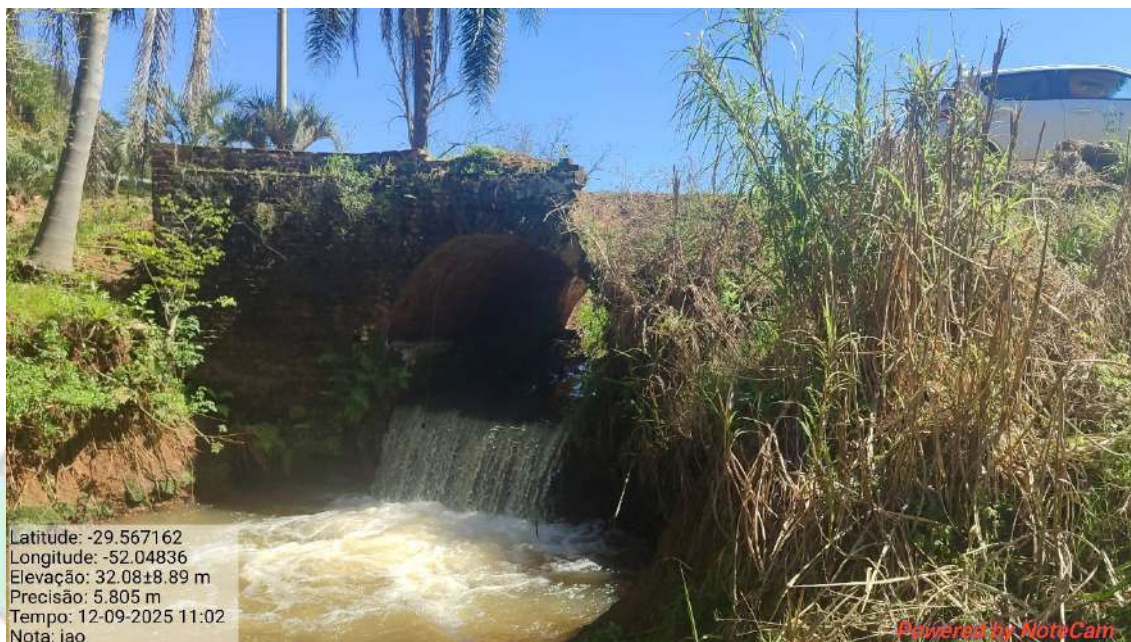
Imagem 5 – Queda de borda + Erosão Solo
