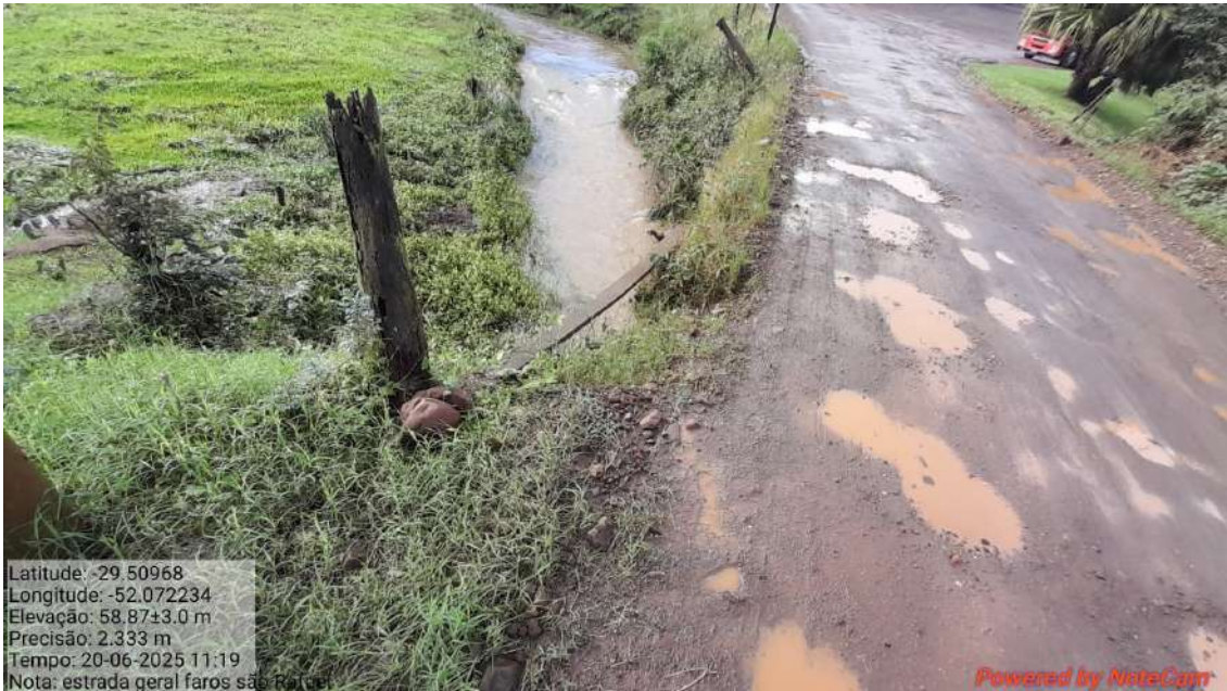
Imagem 5 – Laje com estrutura degradada e erosão pista
