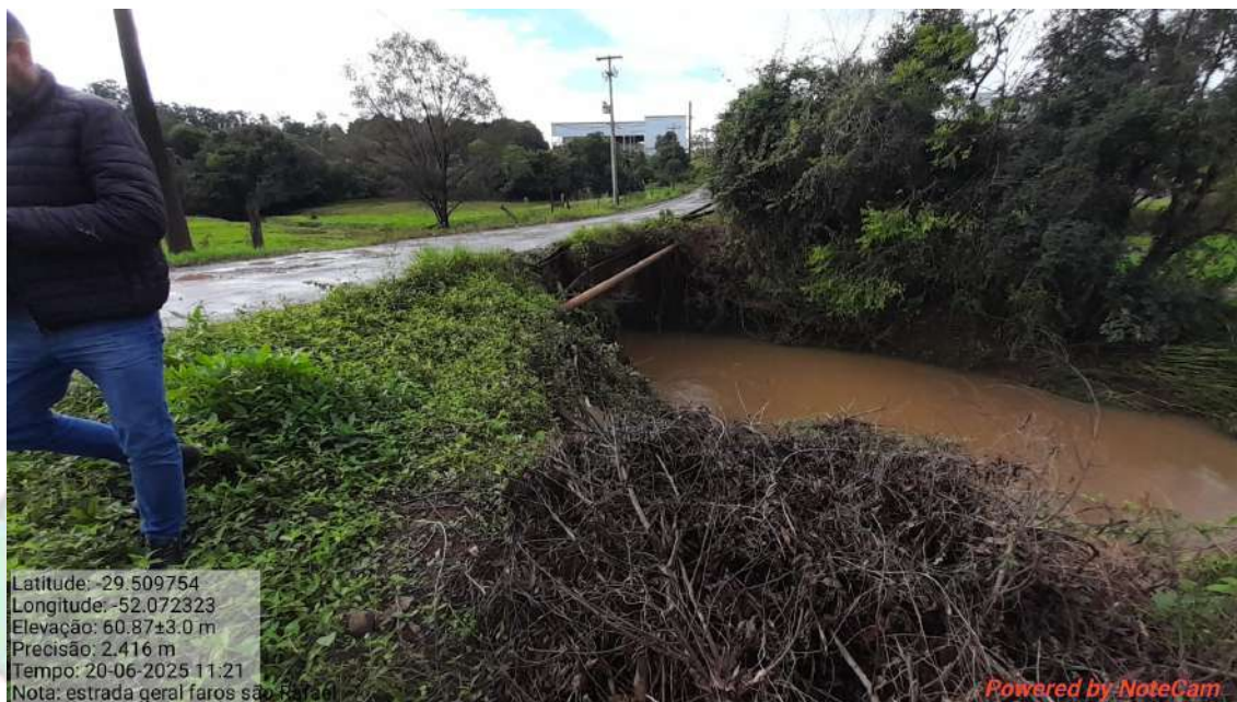
Imagem 3 – Estreitamento de pista e carreamento de solo
