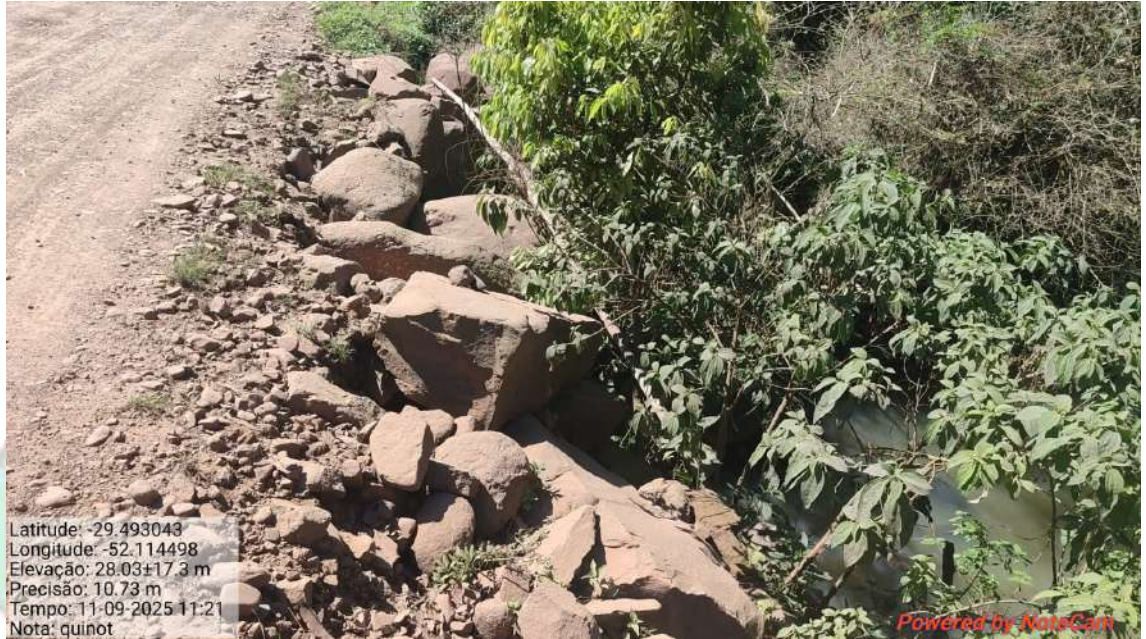
Imagem 5 – Erosão de borda e estreitamento pista
