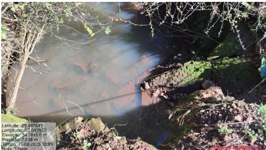
Imagem 4 – Queda de alvenaria na outro bordo
