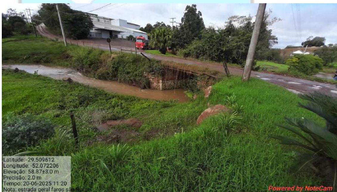
Imagem 4 – Laje com estrutura degradada
